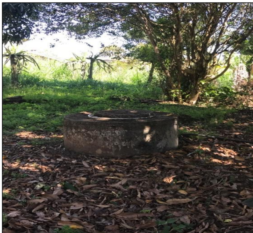
Figura 82 - Poço com altura na abertura visando impedir entrada de águas pluviais.
