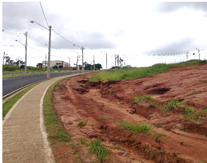
Figura 77: Processo erosivo observado na área urbana.
