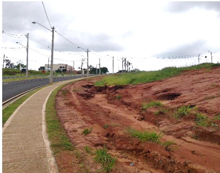
Figura 77: Processo erosivo observado na área urbana.
